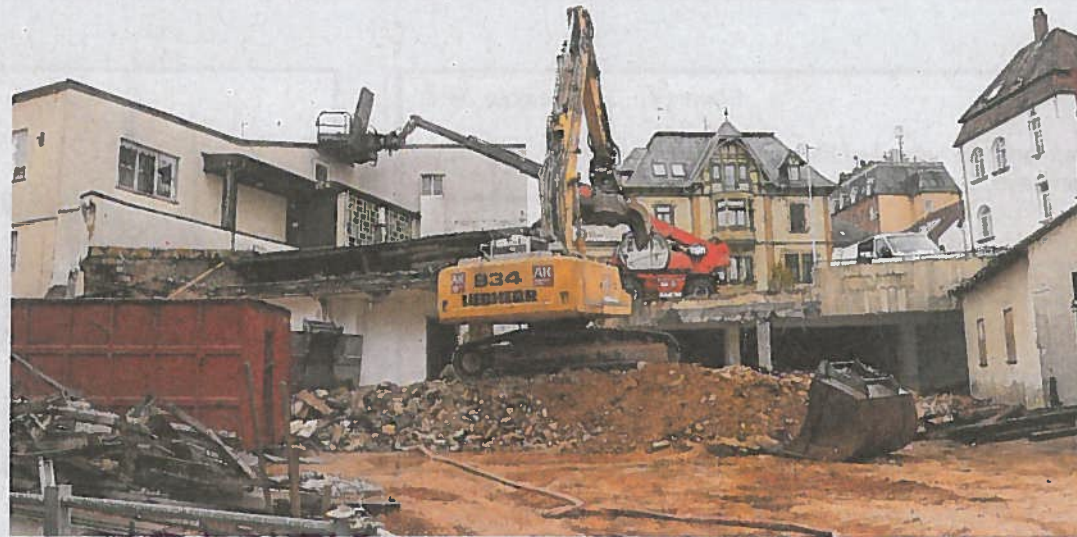
An der Rinderbacher Gasse sind die Bagger bereits zugange, das Gebäude an der Königsturmstraße fällt ab Ende der Woche. Foto: Tom
